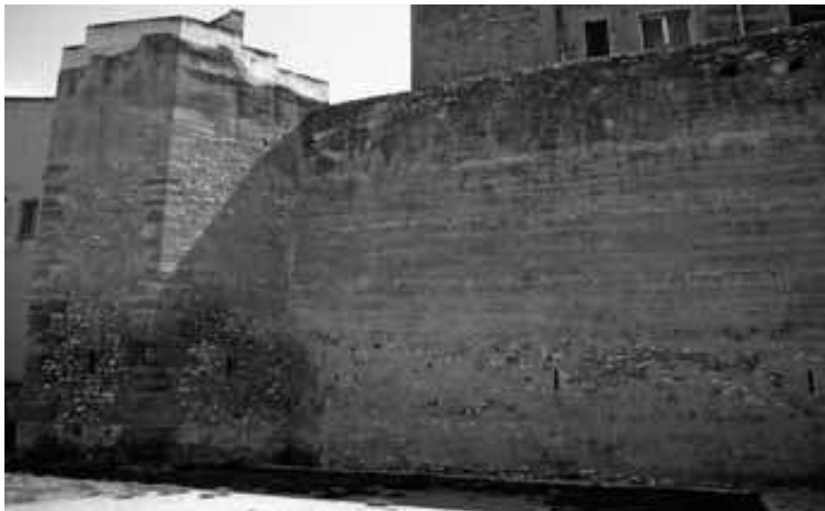
Torre i llenç de la muralla medieval visible al carrer de Sant Pere, prop del de Sant Vicenç. Poden observar-se els senyals de les tapiades, l'ús de pedres sense treballar al basament i de carreus –alguns encoixinats– als angles de la torre, a més d'espitlleres.
